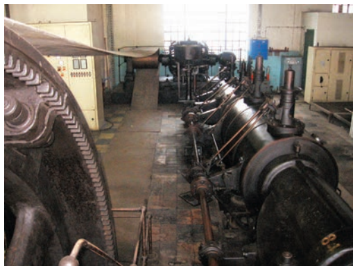
Генератор у Електроцентрали
